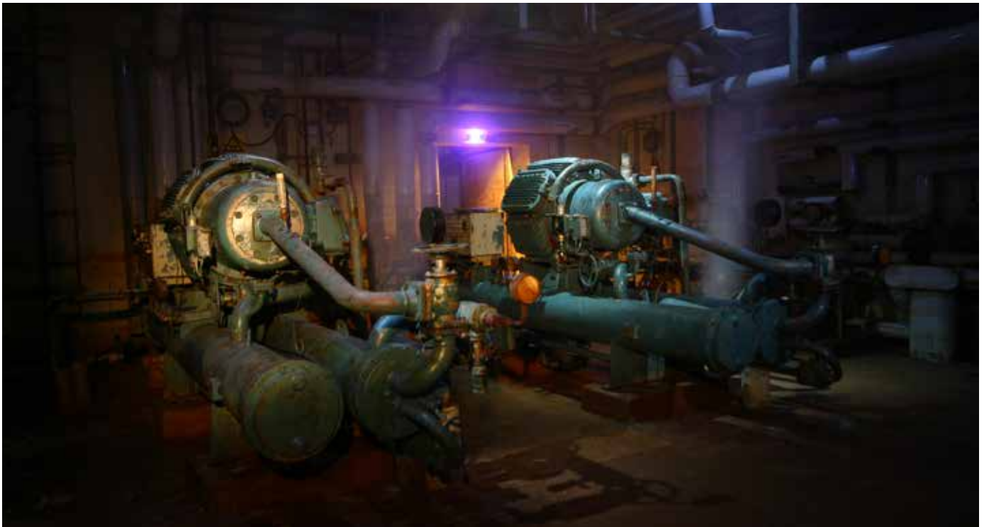
Kaltwassersätze zur Rückkühlung des Kühlwassers
