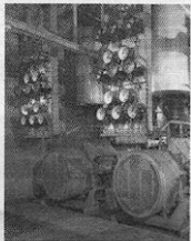
Drei Schiffsdiesels à 850 PS erzeugten je 400 KW Strom.
